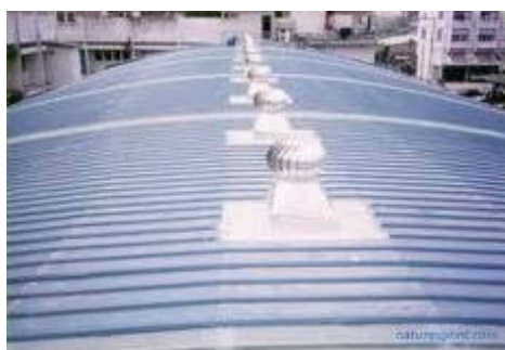
รูปที่ 1.4 พัดลมระบายอากาศบนหลังคาอาคาร
